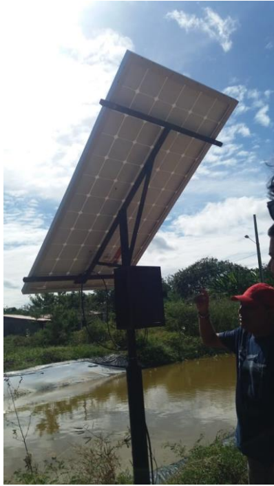
Figura 26 - Placa fotovoltaica instalada na bomba de água do taque. Fonte: Aatoria própria (2019).
