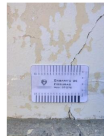
Figura 3: Gabarito de fissuras.
