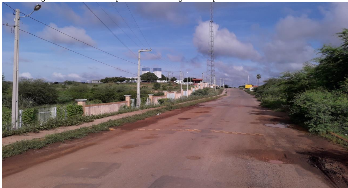
Figura 65. Acesso ao Campus da UFERSA Angicos/RN apresentando vários buracos na via
