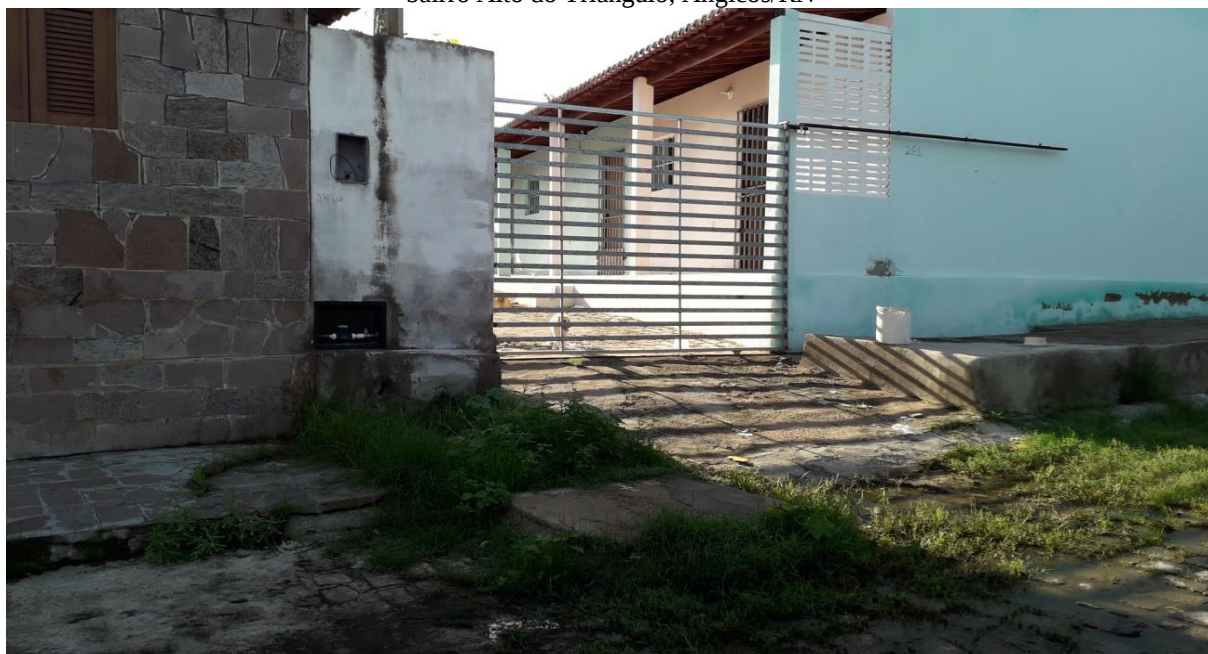
Figura 61. Esgoto ao céu aberto em frente a um condomínio residencial na Rua Vicente Germano Guilherme, bairro Alto do Triângulo, Angicos/RN
