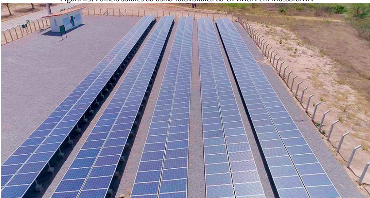
Figura 29. Painéis solares da usina fotovoltaica da UFERSA em Mossoró/RN
