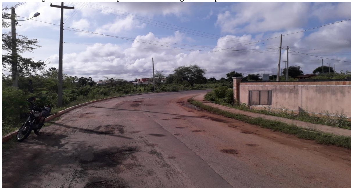
Figura 64. Acesso ao Campus da UFERSA Angicos/RN apresentando vários buracos na via
