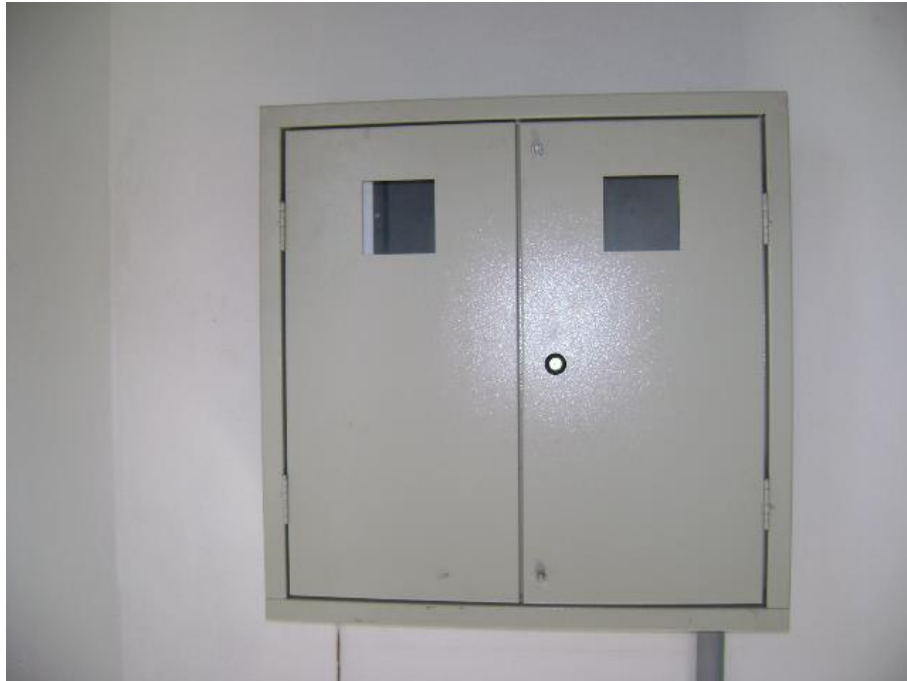
Figura 28 – Quadro de medição
