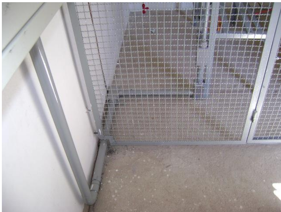
Figura 29 – Eletroduto de ligação
