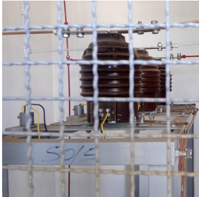
Figura 26 – Transformadores de corrente
