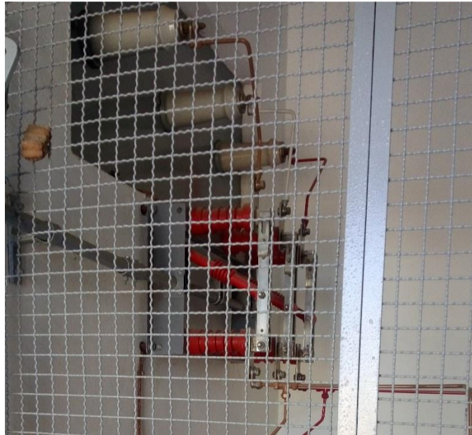
Figura 30 – Chave seccionadora instalada no cubículo
