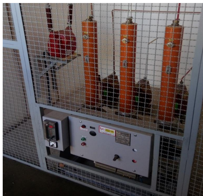
Figura 31 – Relé digital e disjuntor
