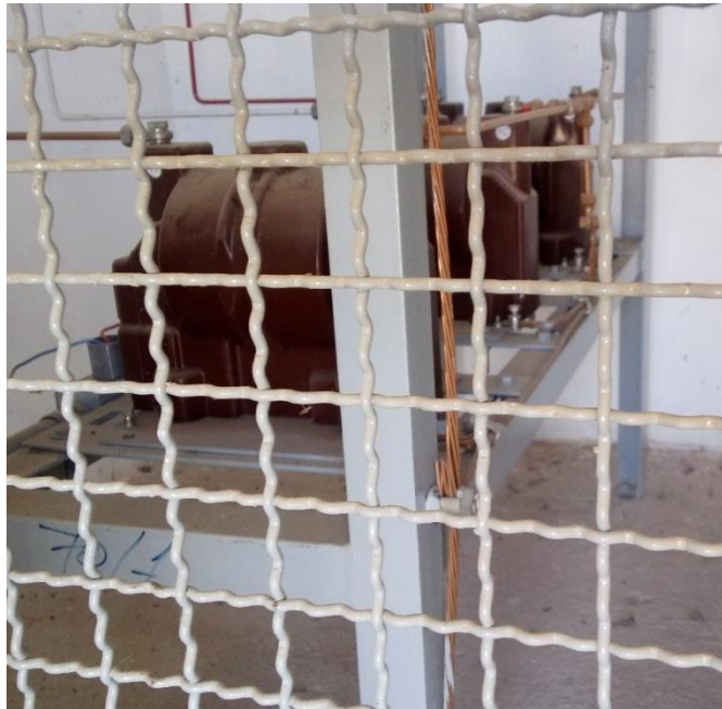
Figura 27 – Transformadores de potencial
