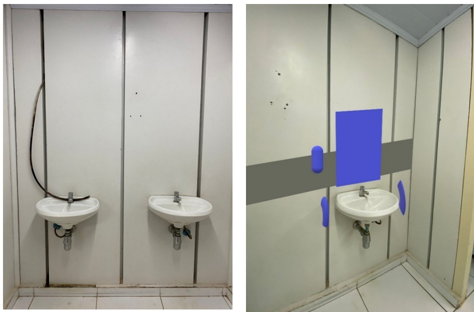
Figura 11 – Ausência de acessório no lavatório e croqui de adequação.
