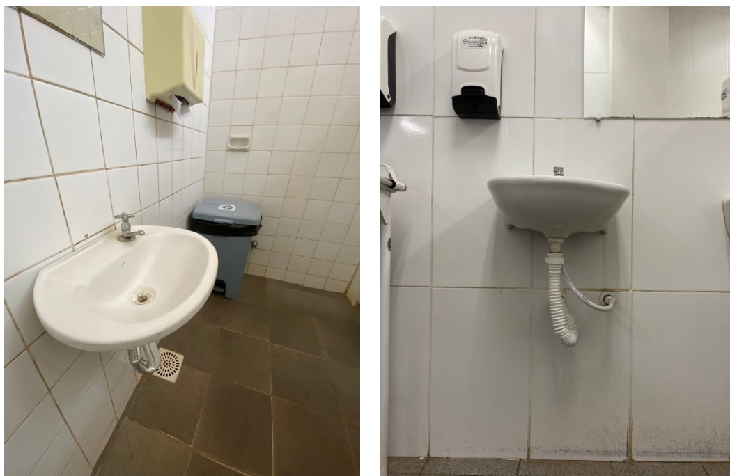
Figura 10 – Ausência de barras de apoio.
