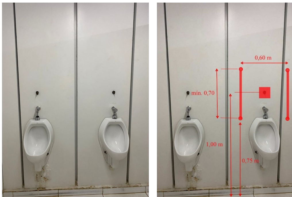
Figura 12 – Situação atual do mictório e croqui de adequação.
