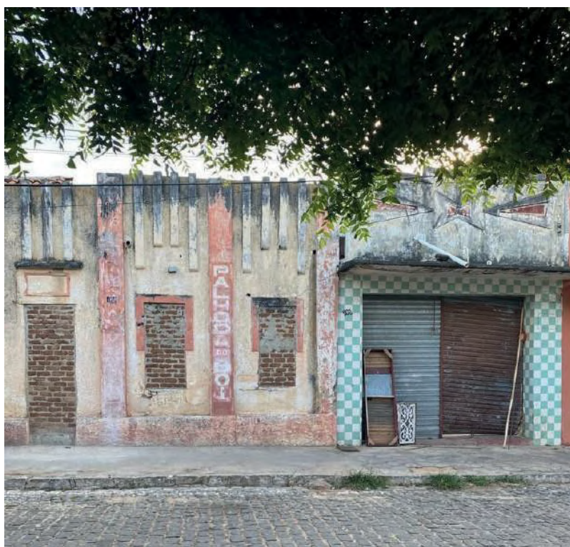
Figura 42 – Imagem de outras edificações comerciais no trecho do mercado, ambas em estado de abandono.
