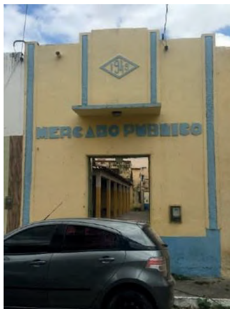
Figura 39 – Situação atual de uma das fachadas do Mercado Público de Alexandria.
