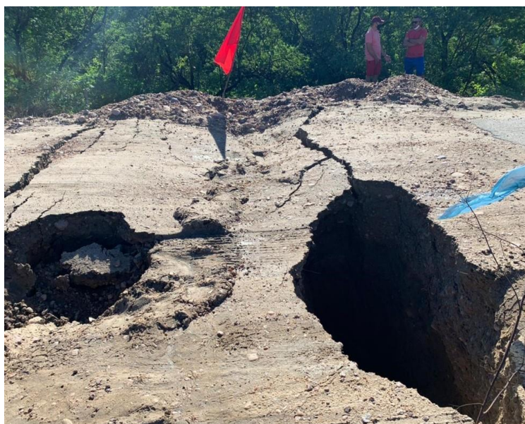
Figura 4: Buraco interdita rodovia RN-118 no interior do RN.
