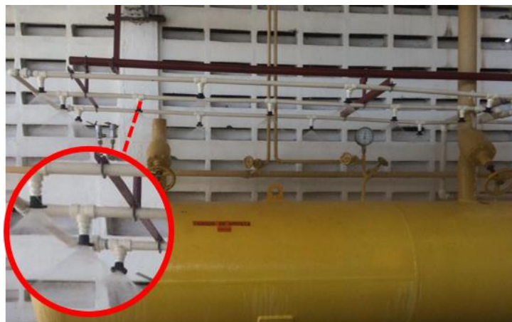
Figura 12 - Chuveiro de segurança no tanque de amônia (Autoria própria, 2021).
