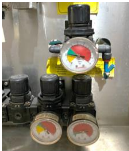
Figura 18 - Identificação de Manômetros (Autoria própria, 2021).
