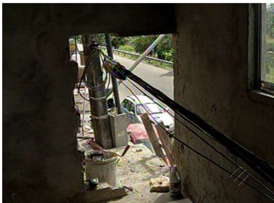
Figura 4- Linhas elétricas dentro de casa no Pará.
