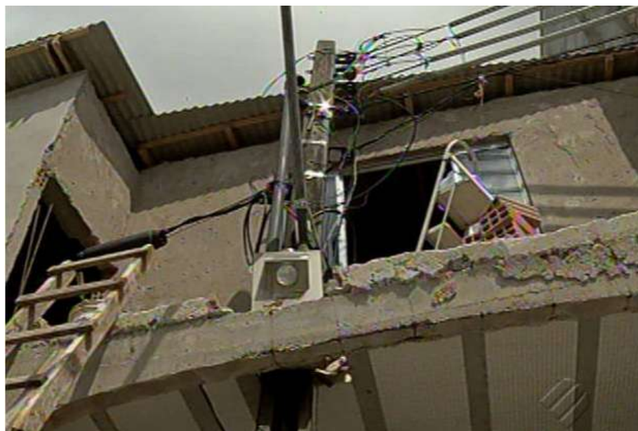
Figura 3- Poste de energia dentro de casa em Belém do Pará.
