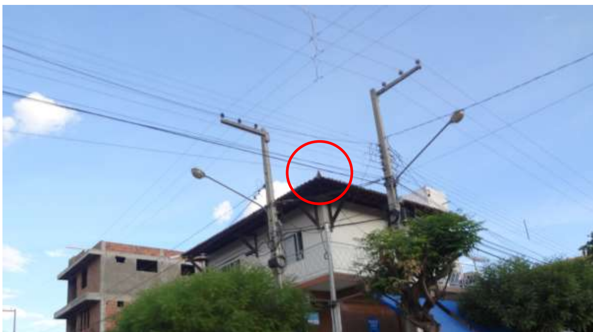
Figura 22- Local 9 - Cimalha irregular
