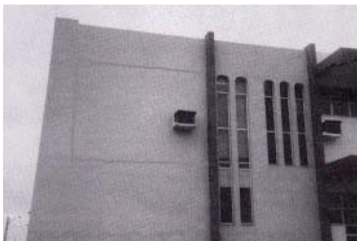
Figura 12- Fissura de destacamento por movimentação térmica da estrutura de concreto armado (THOMAZ, 1989).
