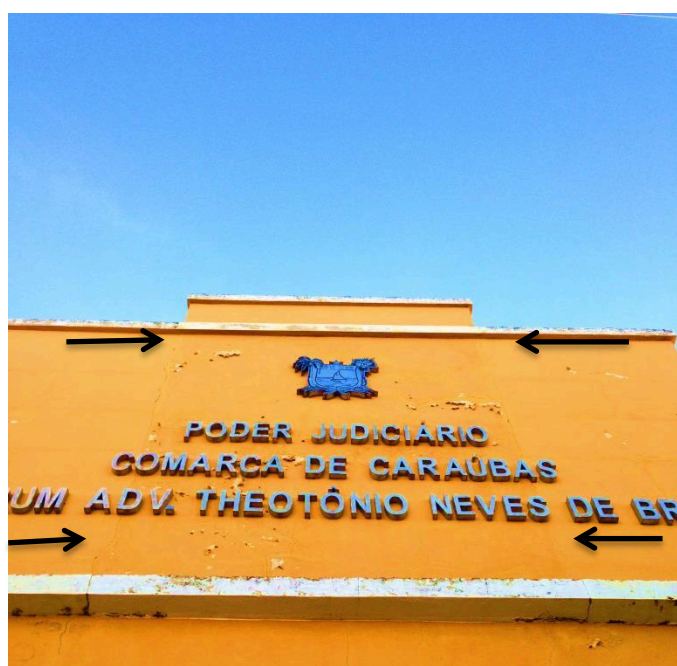
Figura 39 – Fissuras causadas por retração
