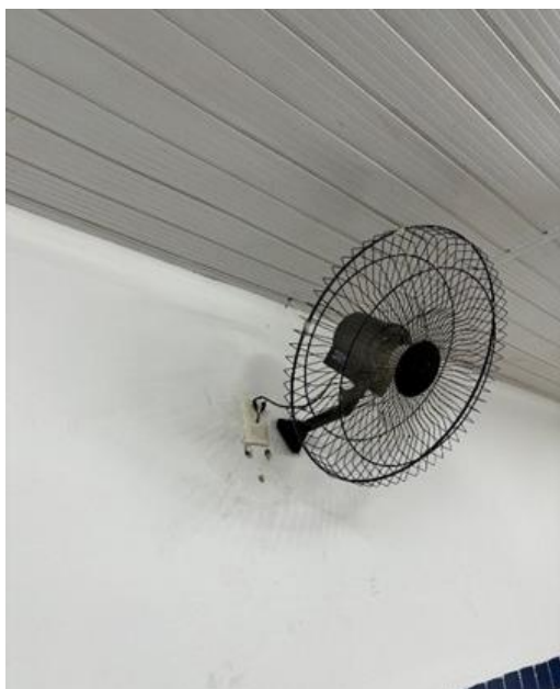
Img. 13 – Ruídos do ventilador [08 de abr de 2025]
