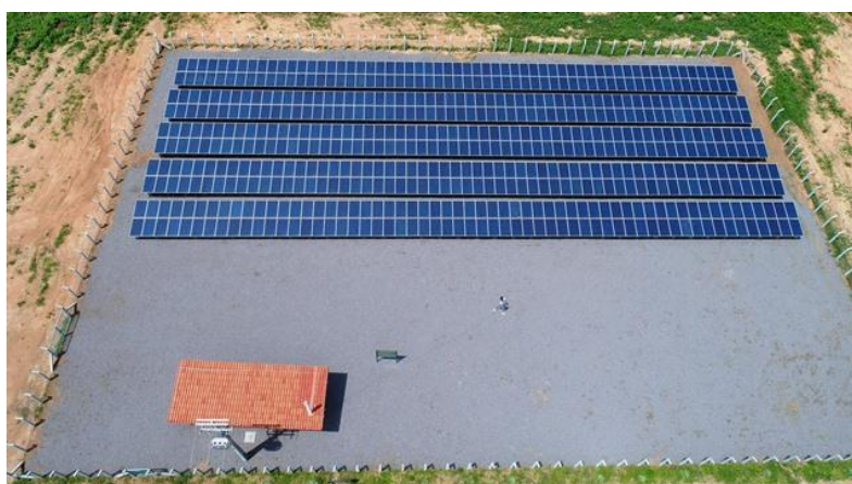
Figura 6 – vista superior da usina solar da UFERSA.
