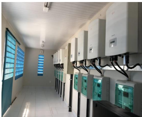
Figura 5 – inversores da usina solar da UFERSA
