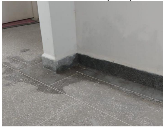
Figura 19 - Vazamento em cano ramal principal dentro da parede.
