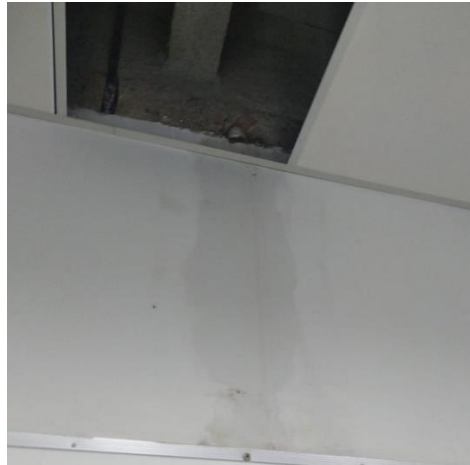
Figura 18 - Vazamento na conexão.
