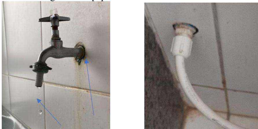
Figura 20- Equipamentos hidrossanitário com vazamento.
