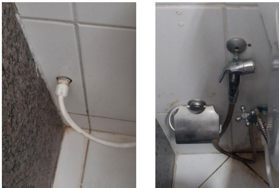
Figura 16 - Equipamentos com problemas de vazamento.
