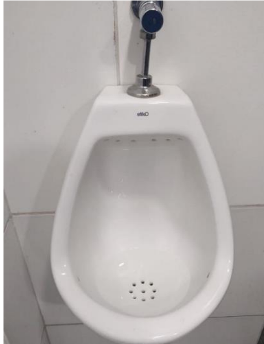
Figura 15 - Mictório nos blocos de aulas UFERSA.
