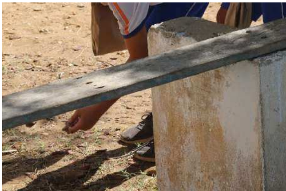
Figura 127 –Banco deteriorado, faltando uma das tábuas de madeira.
