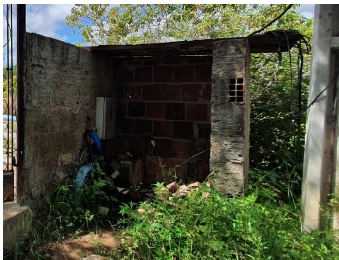
Figura 33 – Cômodo onde localiza-se o quadro de comando.
