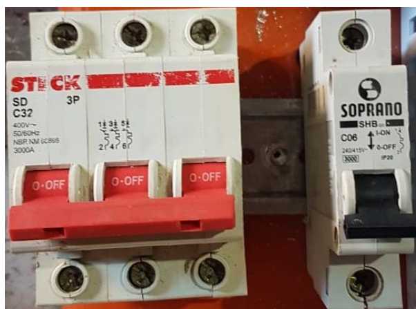
Figura 40 – Disjuntores termomagnéticos para proteção e seccionamento do circuito.
