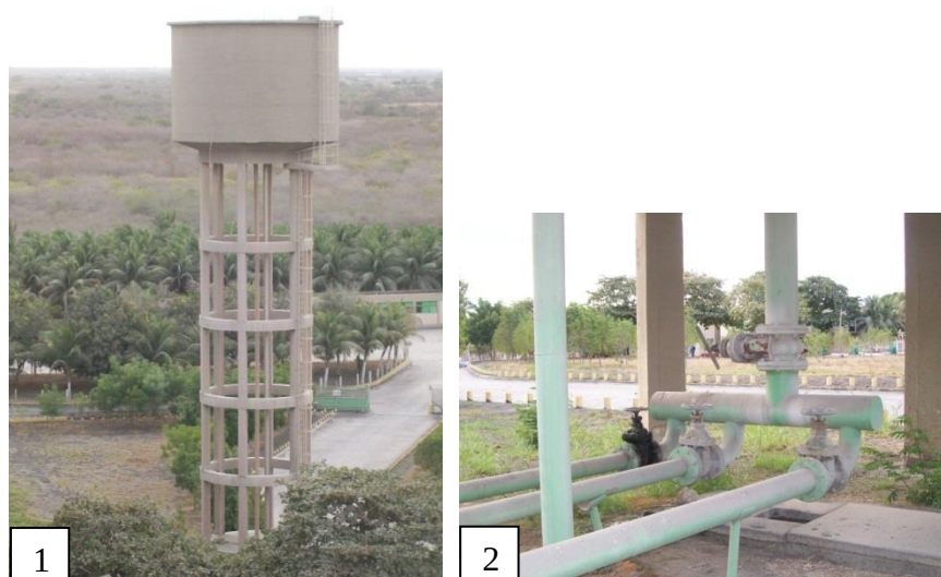
Figura 17 – (1) Caixa d'água geral, e (2) Tubulações de abastecimento de água para os processos. Fonte: Autoria própria, 2012.
