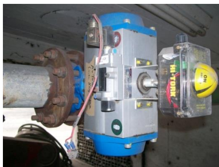
Figura 29 – Válvula eletropneumática para a manobra de abastecimento de água do poço para a caixa dos escritórios.
