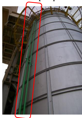
Figura 15 – Tubulações de água de abastecimento e retorno dos bicos pulverizadores da torre de refrigeração do forno rotativo.
