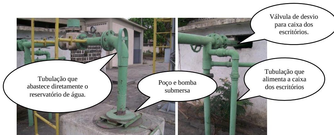
Figura 18 – Válvulas de manobra do SAA.
