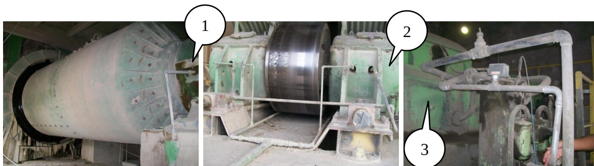
Figura 14 – (1) Mancal moinho de bolas, (2) Mancal dos rolos de apoio do forno rotativo, e (3) Redutor do acionamento do moinho de bolas.
