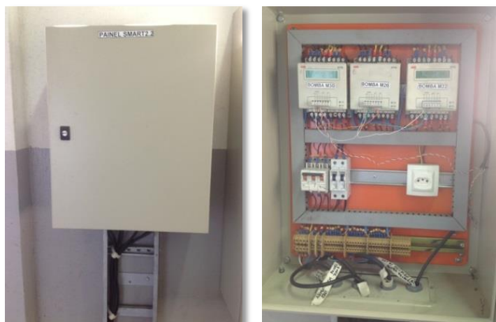
Figura 22 – Painel Smart 2.2 para medição de energia elétrica das bombas M30, M26 e M22.
