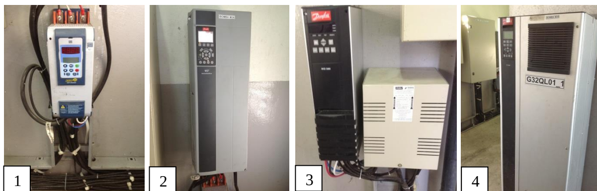
Figura 23 – Em (1) e (2) Soft-Start Weg e Inversor de Frequência Danfoss para a bomba M26, e em (3) e (4) Soft-Start e Inversor de Frequência, ambos Danfoss para bomba M30.
