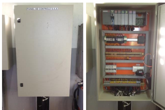
Figura 25 – Painel de Controle do SAA.
