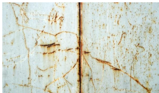
Figura 8: Corrosão filiforme sobre alumínio
