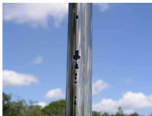
Figura 6: Corrosão por pite em tudo de aço inoxidável
