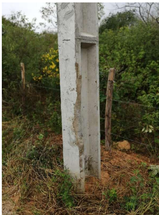
Figura 21: Poste com corrosão exposta
