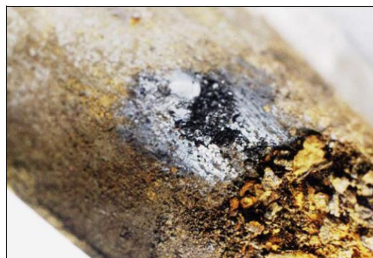
Figura 11: Corrosão grafitica em um tudo feito de ferro cinzento
