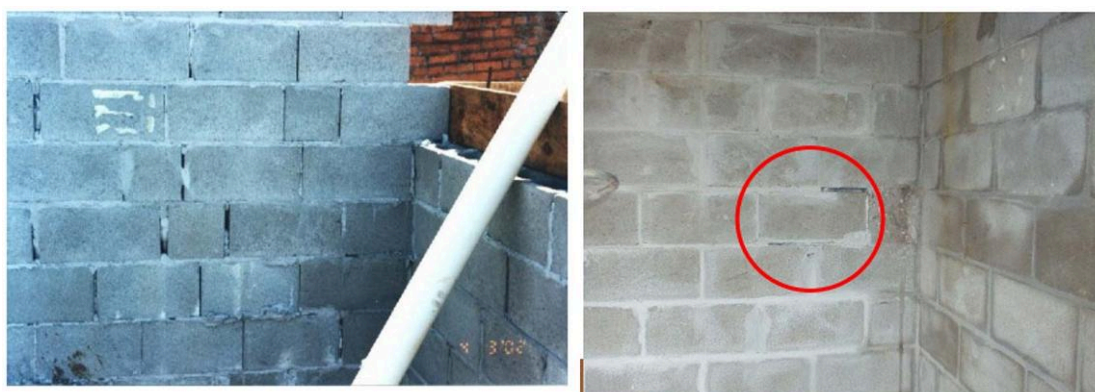
Figura 35 – Exemplo de preenchimento inadequado e falhas nas juntas de argamassa
