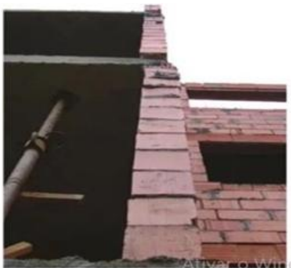
Figura 37 – Desvios de prumo decorrentes de falhas na modulação vertical
