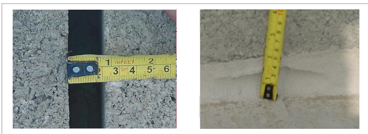
Figura 38 – Juntas excessivamente espessas para compensação modular
