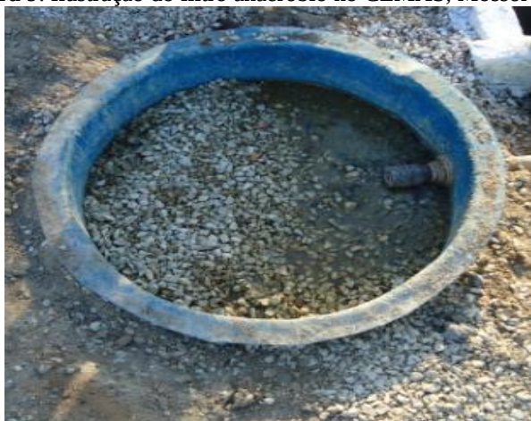
Figura 9. Ilustração do filtro anaeróbio no CEMAS, Mossoró-RN.
