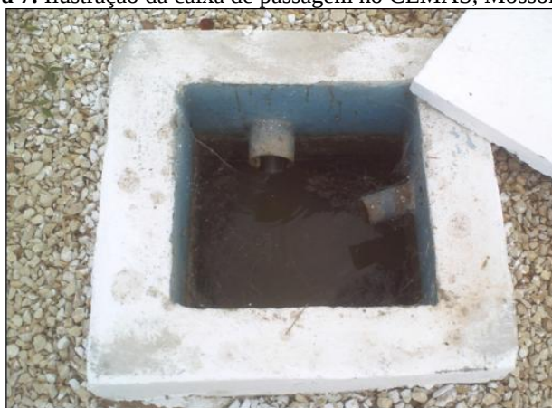
Figura 7. Ilustração da caixa de passagem no CEMAS, Mossoró-RN.
