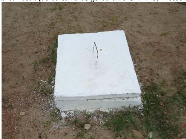
Figura 6. Ilustração da caixa de gordura no CEMAS, Mossoró-RN.
