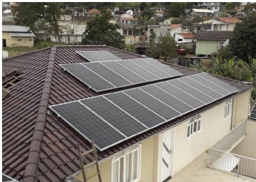
Figura 10 - Sistema BAPV aplicado a cobertura de uma edificação.
