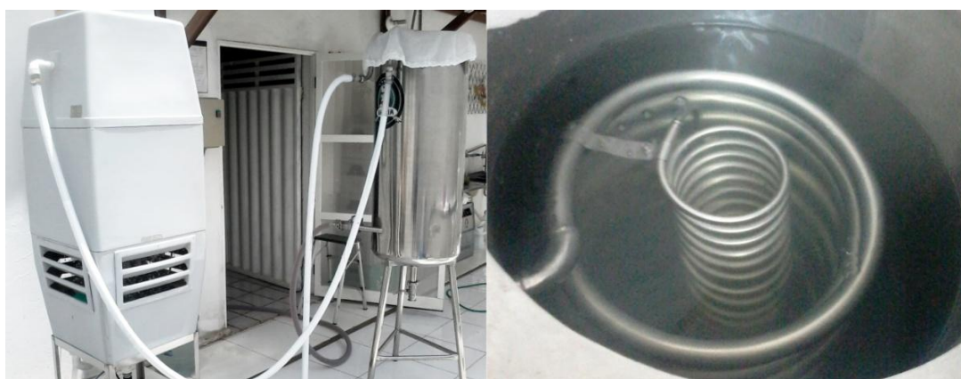
Figura 8: Exaustor e trocador de calor em funcionamento e detalhe da serpentina do trocador.
