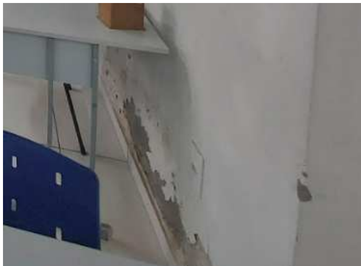
Figura 45 – Presença de umidade ascendente e deslocamento do revestimento e reboco na Biblioteca Valter Brito Guerra – Apodi/RN.
