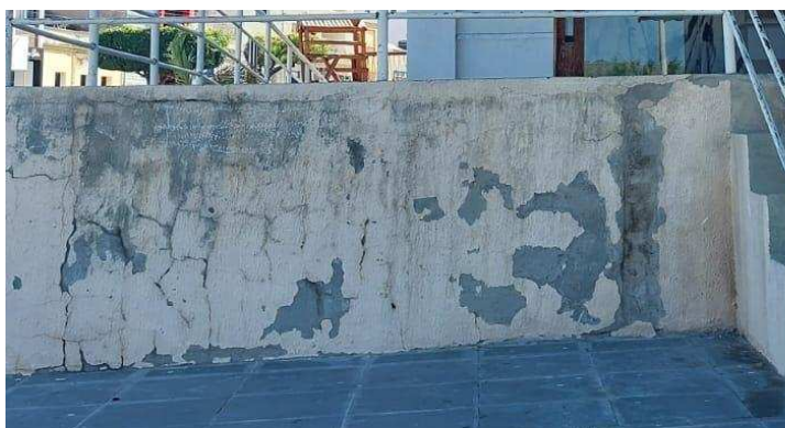
Figura 44 – Presença de umidade, fissuras mapeadas e deslocamento do revestimento, em algumas partes há perda do reboco e emboço na Biblioteca Valter Brito Guerra – Apodi/RN.
