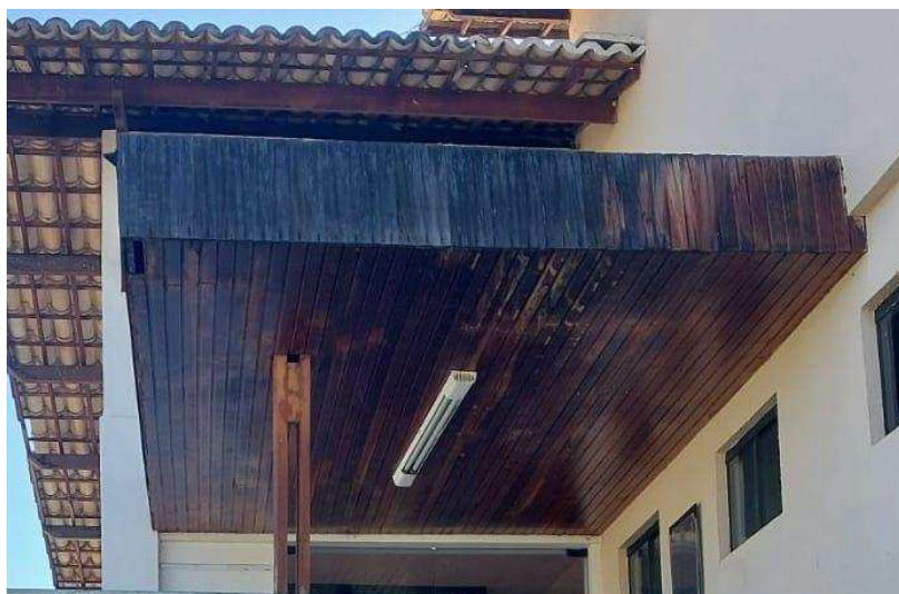
Figura 43 – Degradação da madeira na marquise da Biblioteca Valter Brito Guerra – Apodi/RN.
