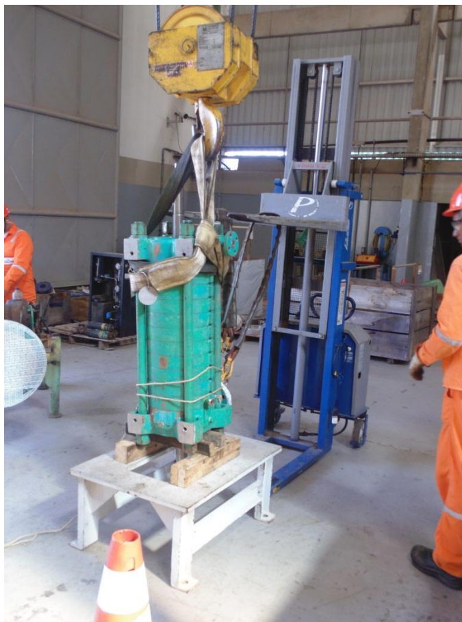
Figura 18: Bomba de múltiplos estágios na posição vertical para desmontagem
