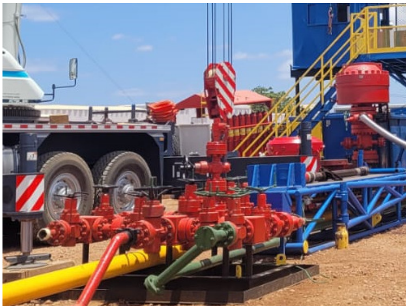
Figura 4 - Choke Manifold instalado na sonda (Autoria Própria).
