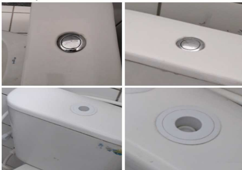
Figura 8: Bacia sanitária com defeito no botão de acionamento na Escola Estadual de Educação Profissional Osmira Eduardo de Castro
