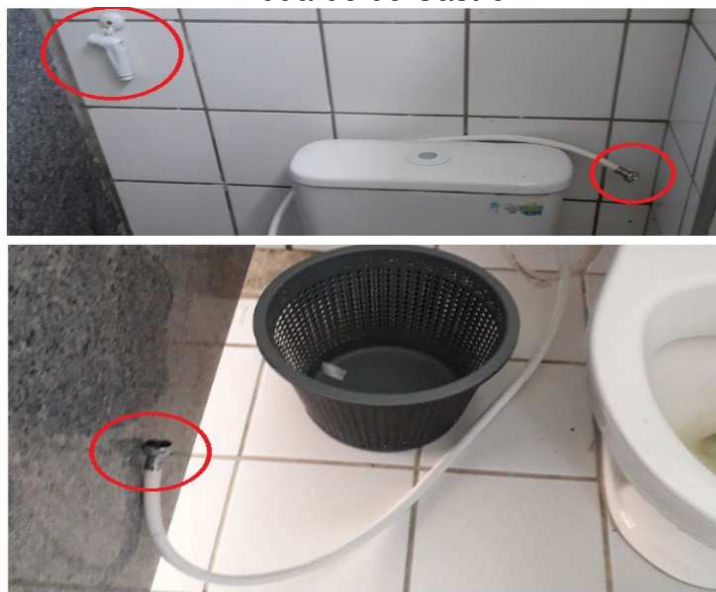
Figura 11: Duchas quebradas na Escola Estadual de Educação Profissional Osmira Eduardo de Castro
