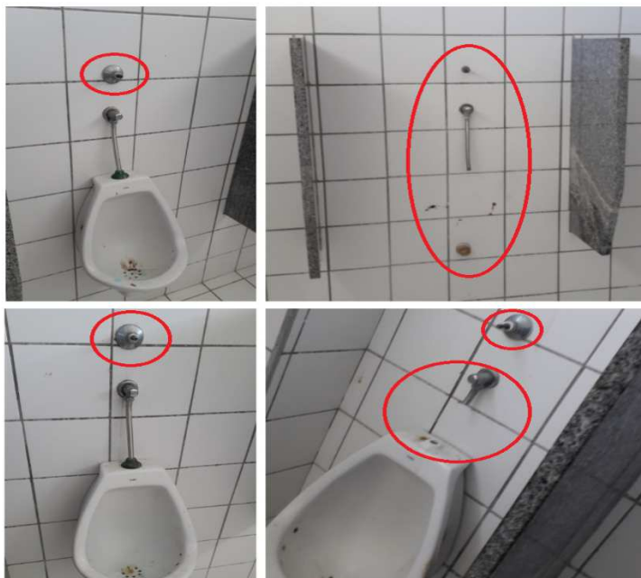
Figura 12: Mictórios quebrados na Escola Estadual de Educação Profissional Osmira Eduardo de Castro
