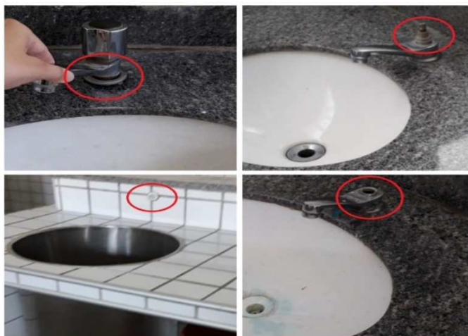
Figura 10: Torneiras sem condições de uso na Escola Estadual de Educação Profissional Osmira Eduardo de Castro
