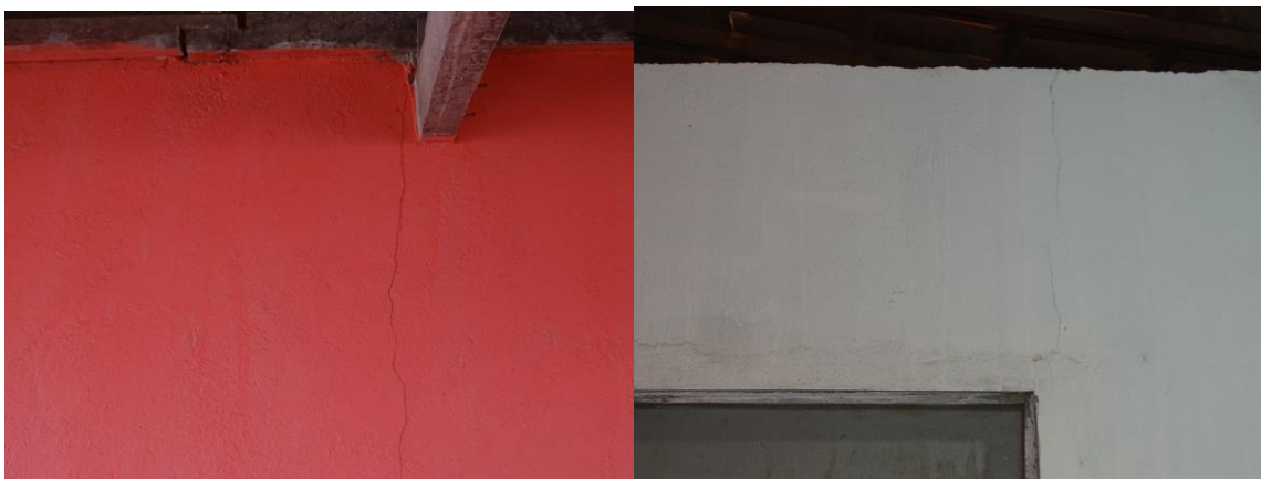
Foto 08 - Rachaduras Provocadas pelos Aerogeradores
