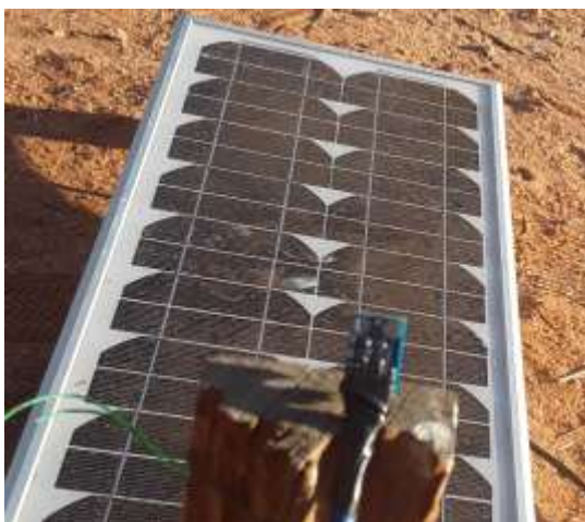
Figura 32: Instalação do sensor de temperatura infravermelho
