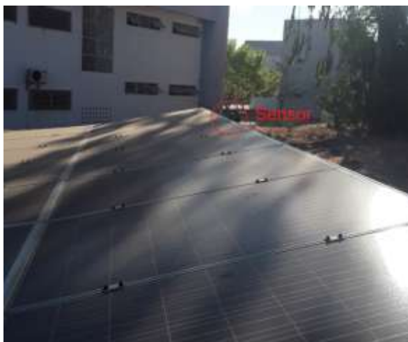
Figura 54: Local de instalação do sensor de irradiância solar
