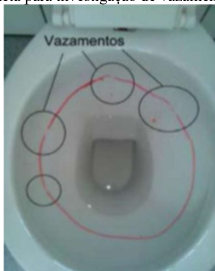
Figura 19: Teste da caneta para investigação de vazamentos em bacias sanitárias
