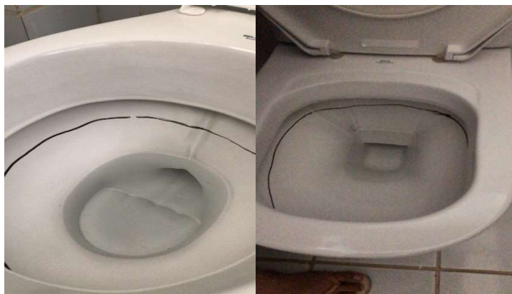
Figura 34: Vazamentos não visíveis identificados no Laboratório de Engenharia I. por meio do teste da caneta
