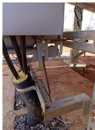
Fig. 13. Aterramento do inversor e a sua estrutura de suporte à malha geral.
