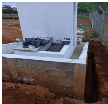
Fig. 10. Malha de aterramento do banheiro.
