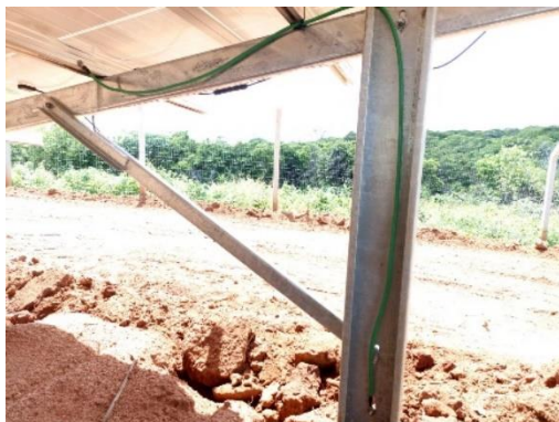
Fig. 17. Aterramento entre pilar de fixação e os trilhos.
