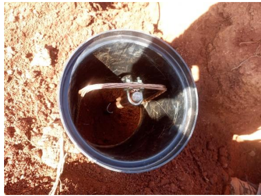
Fig. 18. Haste com condutores de aterramento dentro da caixa de inspeção.
