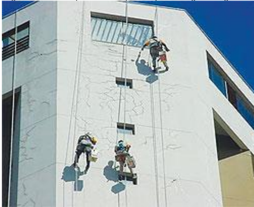
Figura 7 - Fissura mapeada causada por retração de secagem da argamassa.
