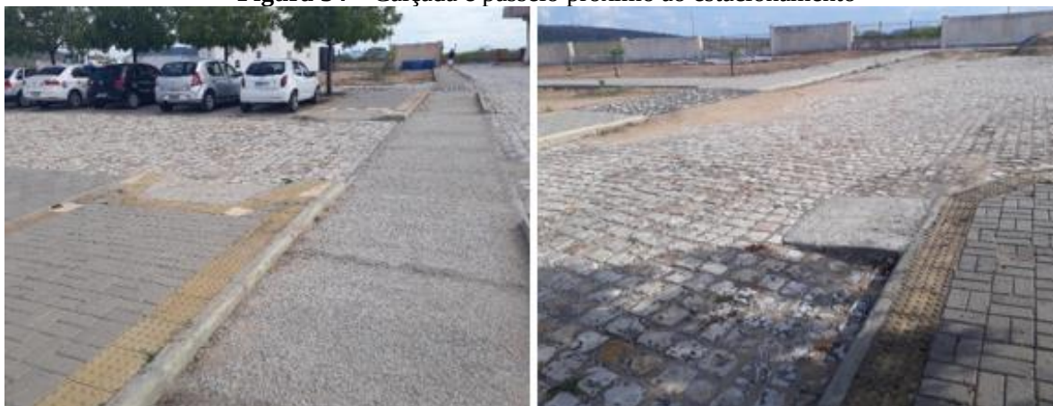
Figura 34 – Calçada e passeio próximo ao estacionamento
