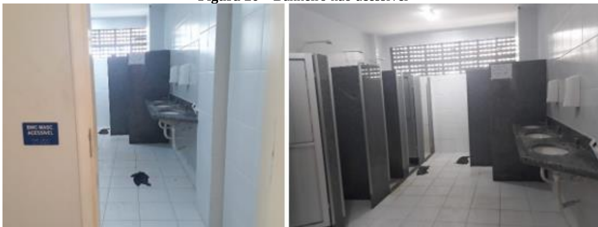
Figura 26 – Banheiro não acessível
