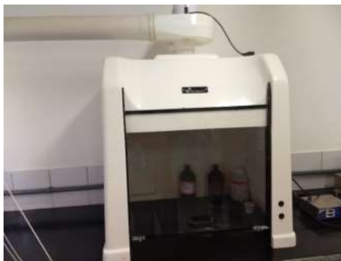
Figura 13 – Capela de exaustão.
