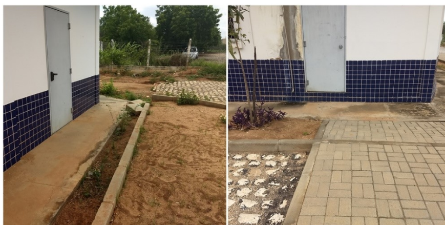
Figura 48 - Saídas de emergência com obstáculos e em desnível.
