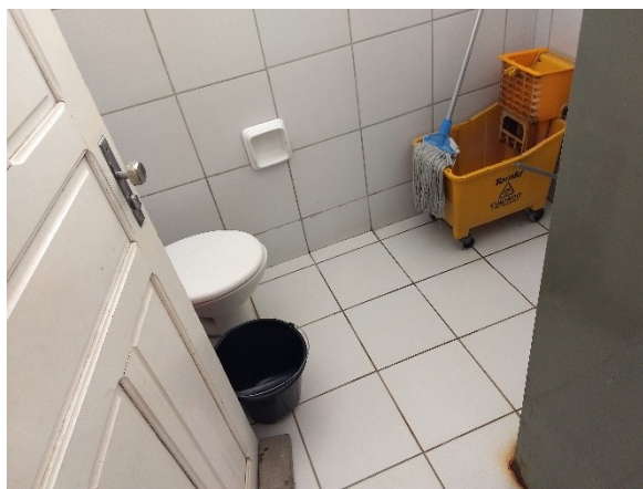
Figura 42 - Porta com sentindo para dentro do banheiro e utilizado como deposito de materiais de limpeza.
