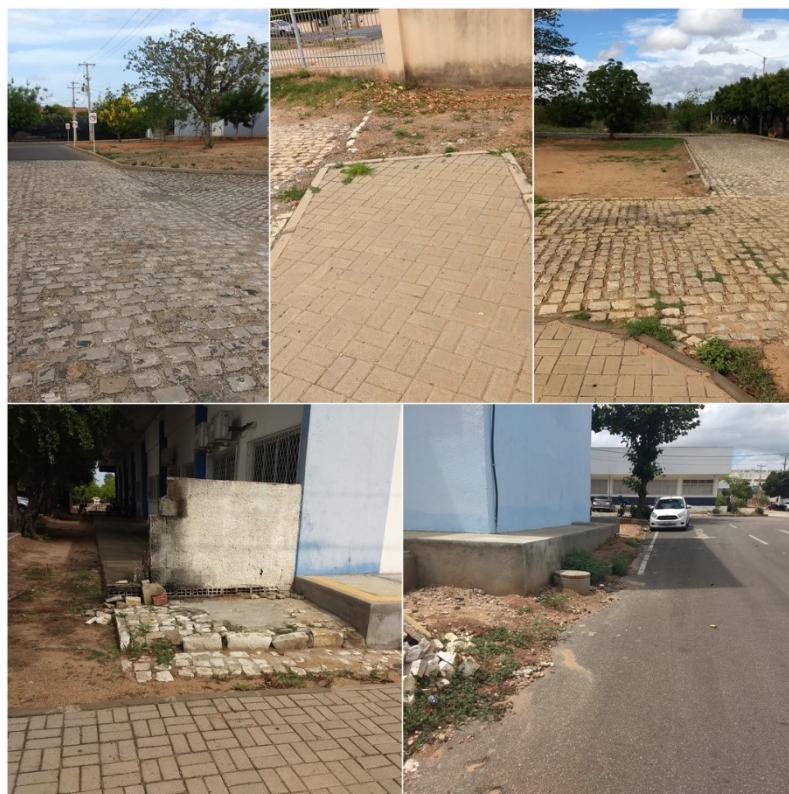
Figura 33 - Alguns trechos faltando calçadas.
