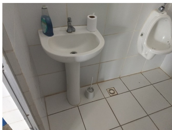
Figura 43 - Lavatório com coluna.
