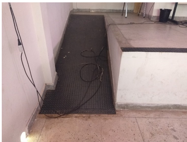
Figura 47 - Rampa do palco com inclinação maior que a admissível.
