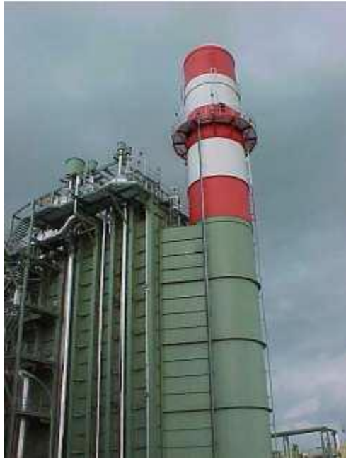
Figura 21- Sistema de exaustão
