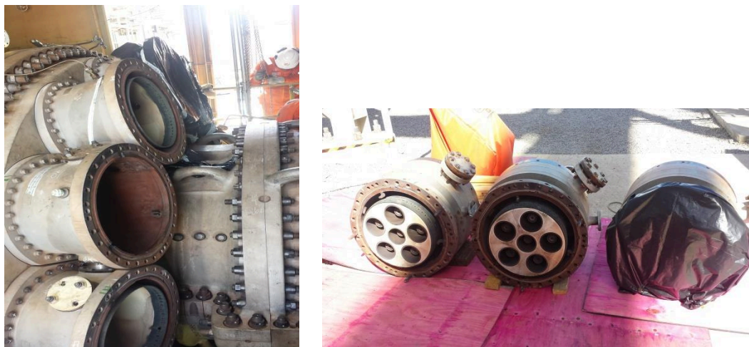
Figura 37 - Liners dos sistema de combustão
