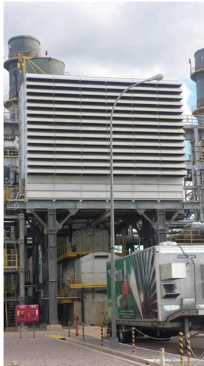
Figura 35 - Casa de filtros
