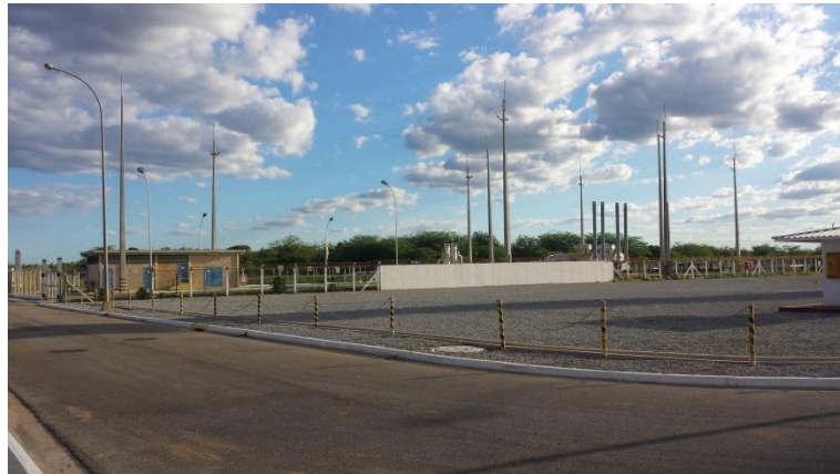
Figura 34 - City Gate no limite de bateria
