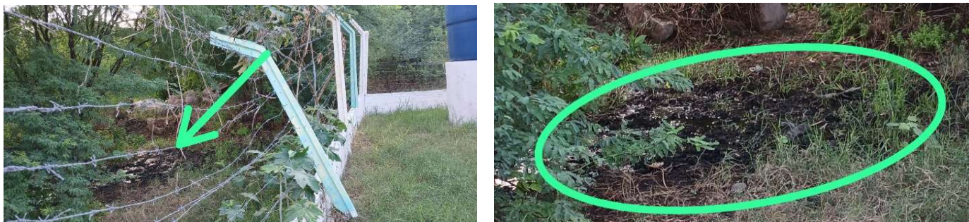
Figura 5 -Despejo dos resíduos gerados no córrego
