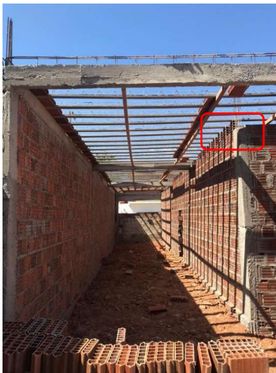
Figura 12 – Pilar sem formação de pórtico com vigas.
