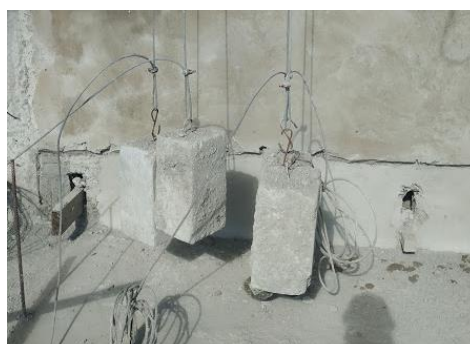
Figura 6. Contrapesos de concreto de um dos andaimes suspensos. (Autoria Própria, 2018)
