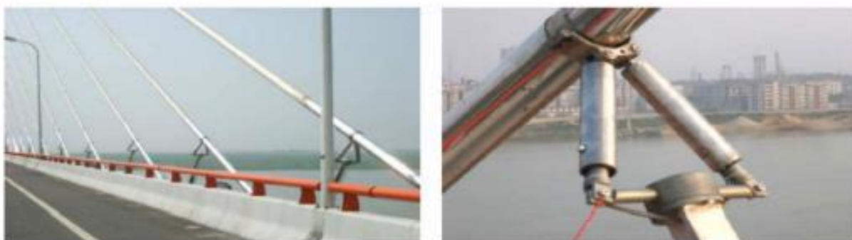
Figura 13 – Ponte Pênsil, China. Um par de amortecedores MR foi colocado em cada um dos cabos de aço de sustentação.
