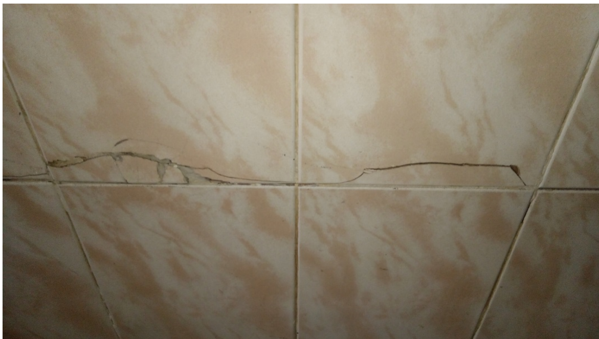
Figura 3. Rachadura nas cerâmicas da parede da residência. (Autoria própria)
