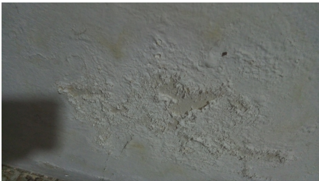
Figura 5. Início de eflorescência na parede de uma residência. (Autoria própria)
