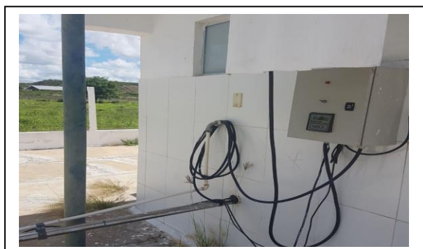
Figura 11: Tubos e monitor de vazão
