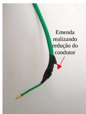
Fig. 2. Condutor de aterramento com diminuição da seção nominal (Autoria Própria)
