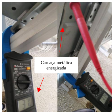
Fig. 4. Energização das carcaças dos ares-condicionados
