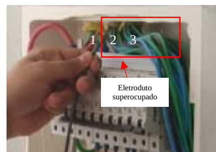
Fig. 3. Quadro de distribuição da clínica (Autoria Própria)
