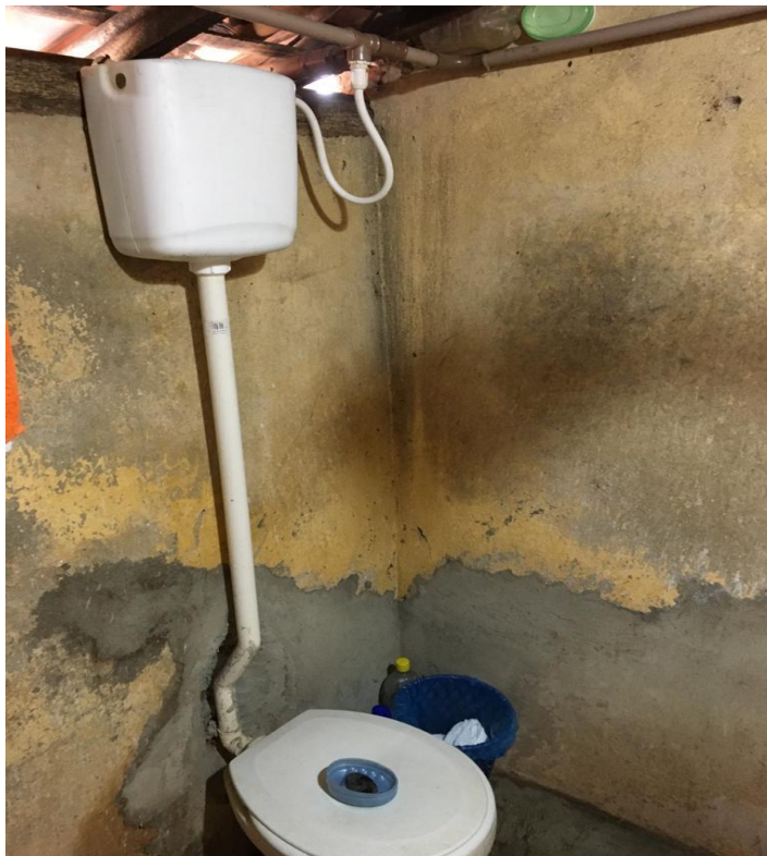
Figura 8 - Vaso sanitário com caixa de descarga.
