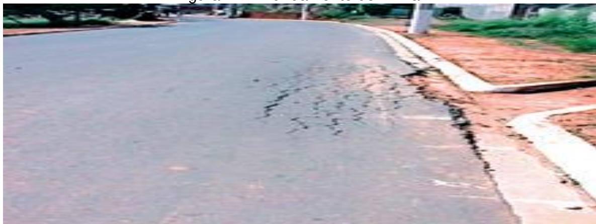
Figura 12 - Afundamento de Trilha
