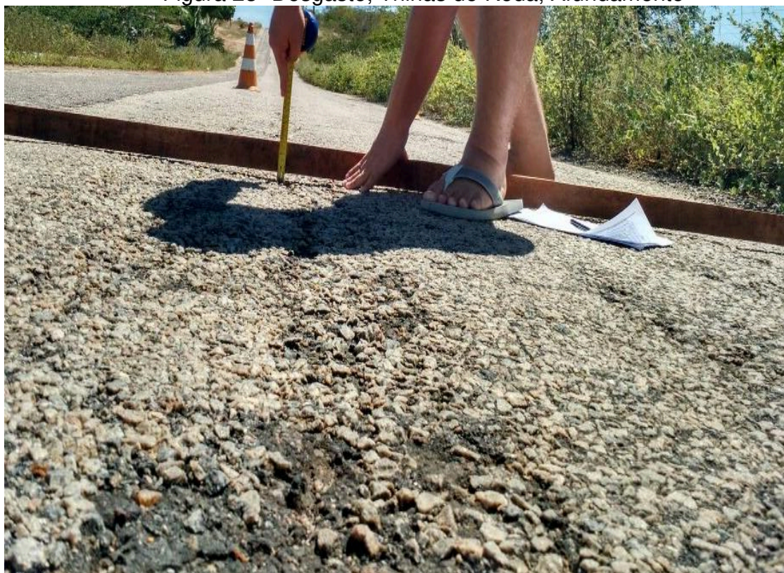
Figura 23- Desgaste, Trilhas de Roda, Afundamento
