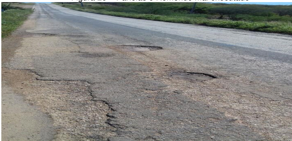
Figura 25 – Painéis e Remendo mal executado
