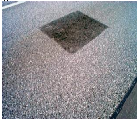
Figura 17 - Remendo bem executado
