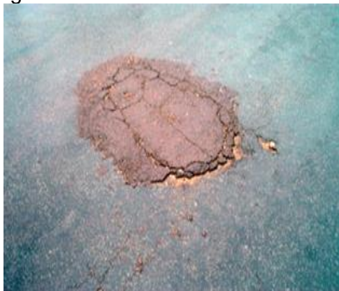
Figura 16 - Remendo mal executado
