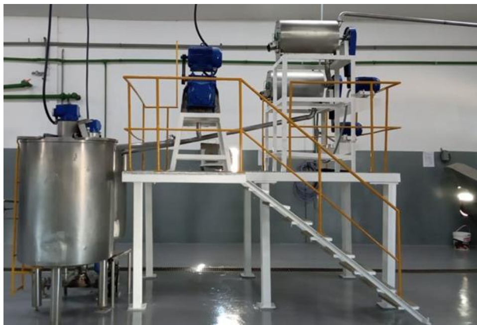
Figura 7. Refinador e tanques de mistura
