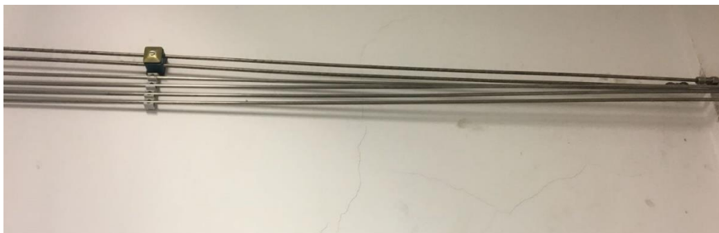
Figura 6: Instalação dos gases no laboratório. (Autoria própria)
