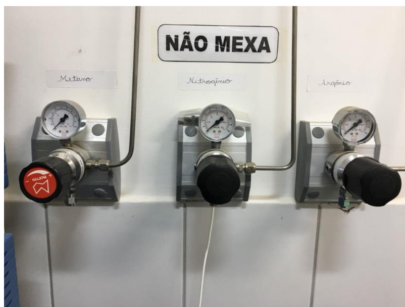
Figura 3: Instalações dos gases no laboratório de processos químicos. (Autoria própria)
