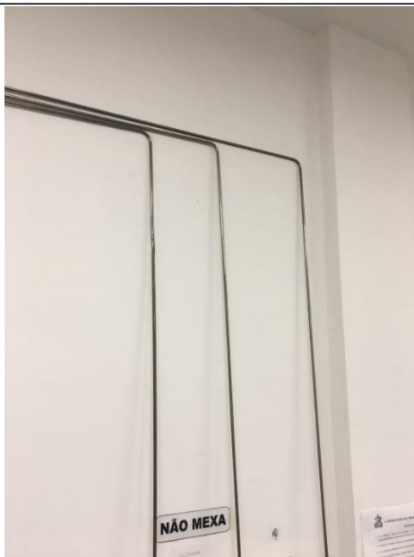
Figura 7: Instalação dos gases no laboratório. (Autoria própria)
