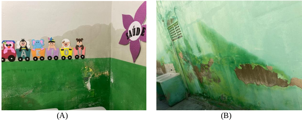
FIGURA 10: Forte umidade na alvenaria
