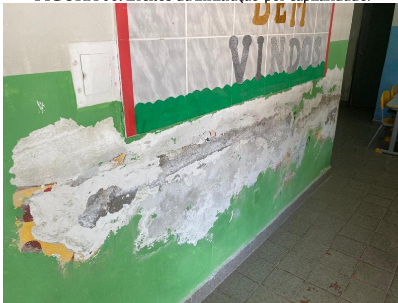
FIGURA 06: Efeitos da infiltração por capilaridade.
