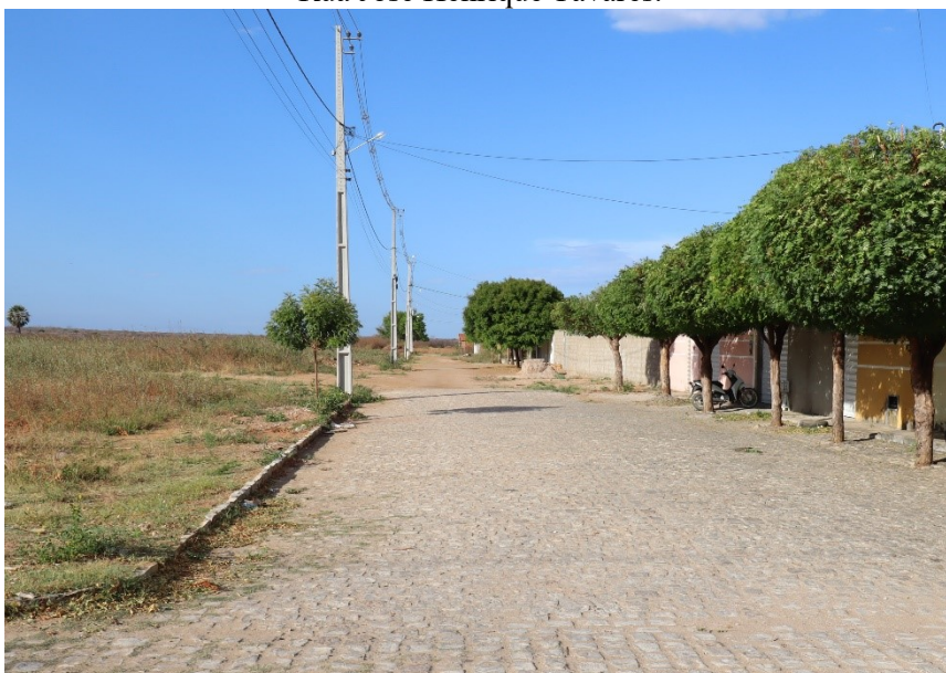
Figura 22: Pavimentação incompleta da Rua José Henrique Tavares.
