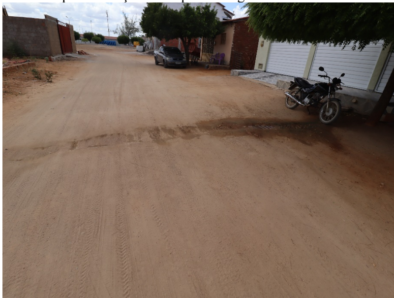
Figura 38: Rua Prefeito Luiz Gurgel Guerra, com pavimentação inadequada e esgoto a céu aberto.
