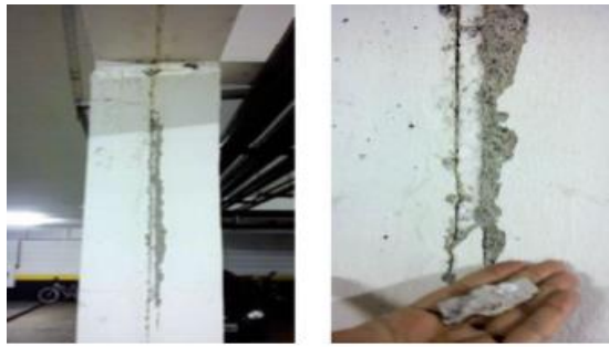
Figura 39– Falhas em juntas de dilatação
