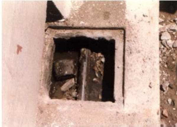
Figura 38– Obstrução de um sistema de drenagem de um viaduto.
