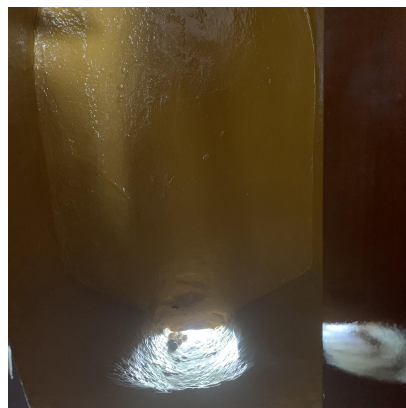
Figura 10: Orifício na parede de origem desconhecida
