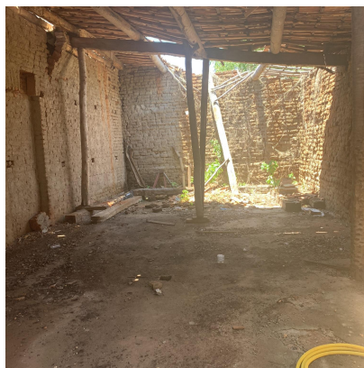
Figura 10: Galpão apresentando estado de conservação precário
