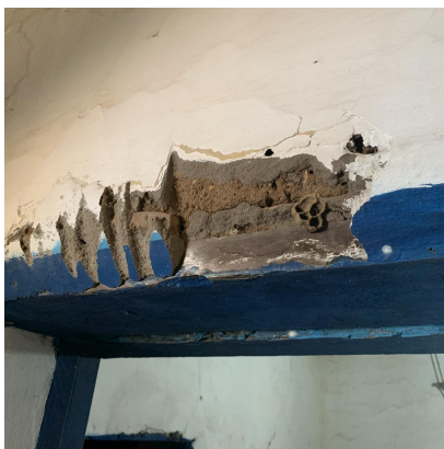
Figura 9: Paredes que apresentam necessidades de reparo
