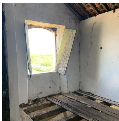
Figura 6: Piso de madeira e esquadrias danificadas
