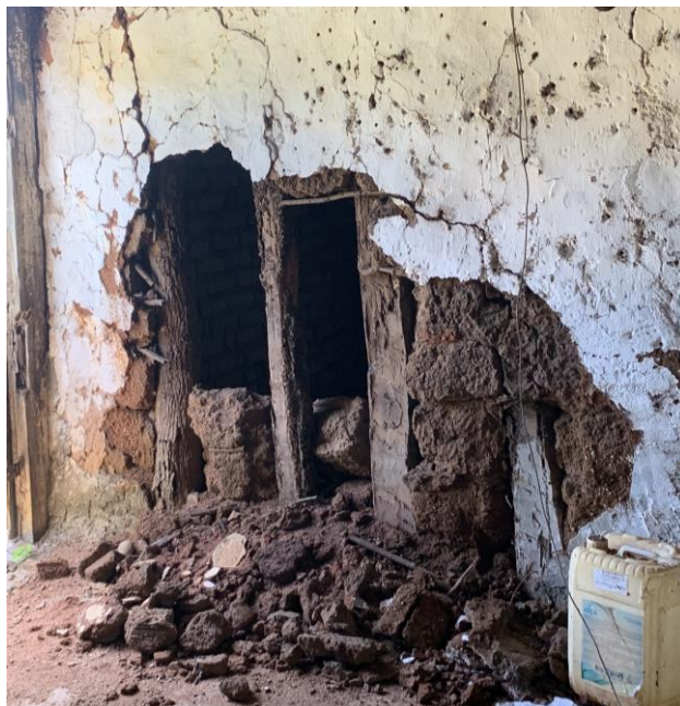
Figura 48 - Edificação de taipa em estado precário de conservação.
