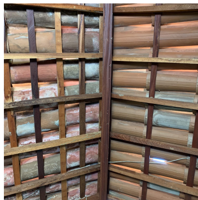
Figura 6: Telhas originais (à esquerda) em contraste com telhas novas (à direita)
