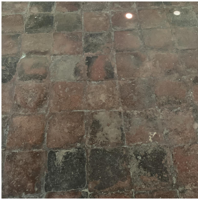
Figura 3: Piso de tijoleira original remanescente
