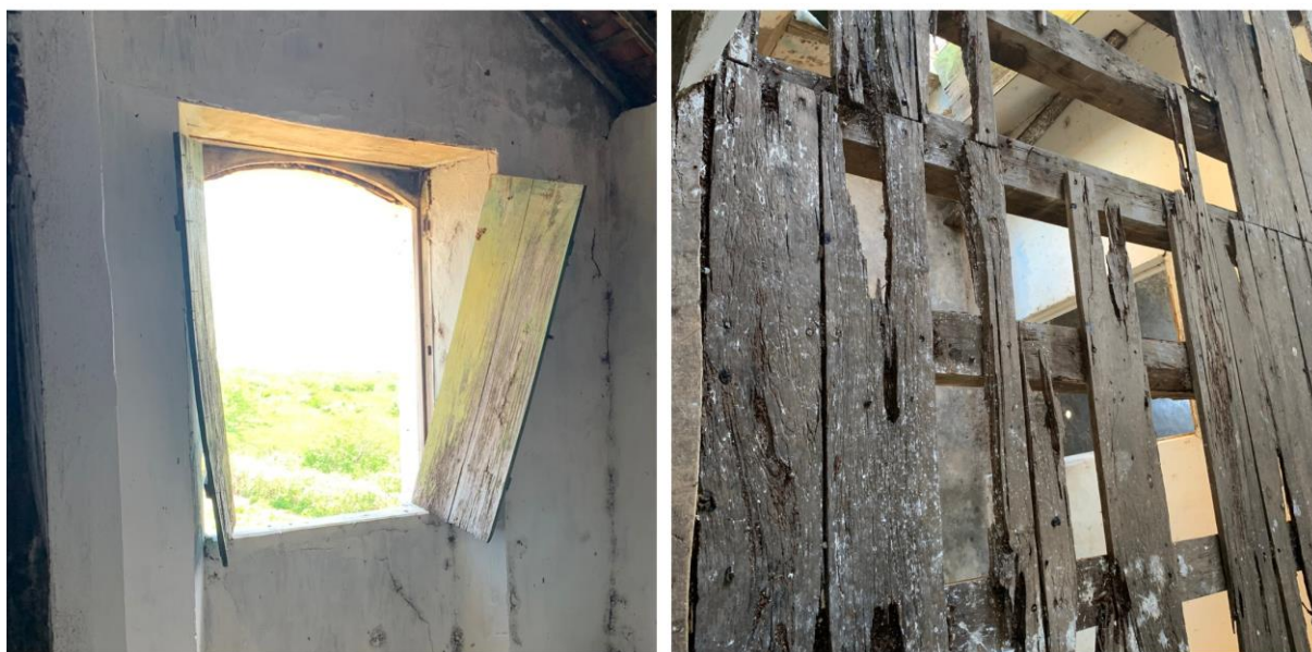
Figura 30 - Desgastes nas esquadrias e piso do sótão.
