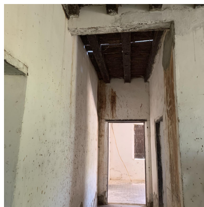
Figura 8: Paredes com sujidades
