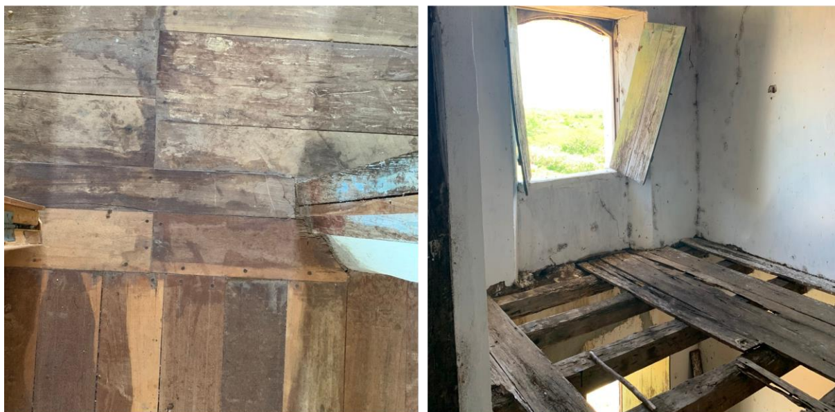
Figura 56 - Exemplos de pisos substituídos e em estado precário de conservação.
