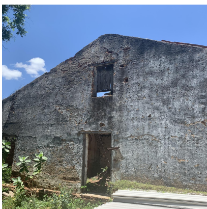
Figura 7: Depósito/galpão em estado precário de conservação
