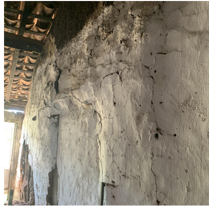
Figura 6: Alveolização nas paredes
