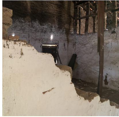
Figura 4: Paredes com partes faltantes
