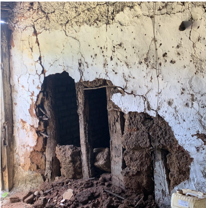
Figura 7: Presença de buracos no interior da edificação
