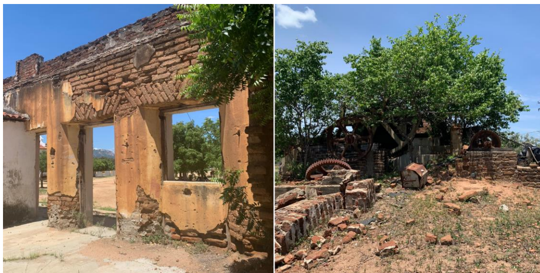
Figura 45 – Partes das edificações apresentando estado de ruína.
