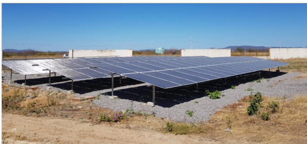
Figura 8 – Painéis solares da usina fotovoltaica da UFERSA campus Pau dos Ferros.
